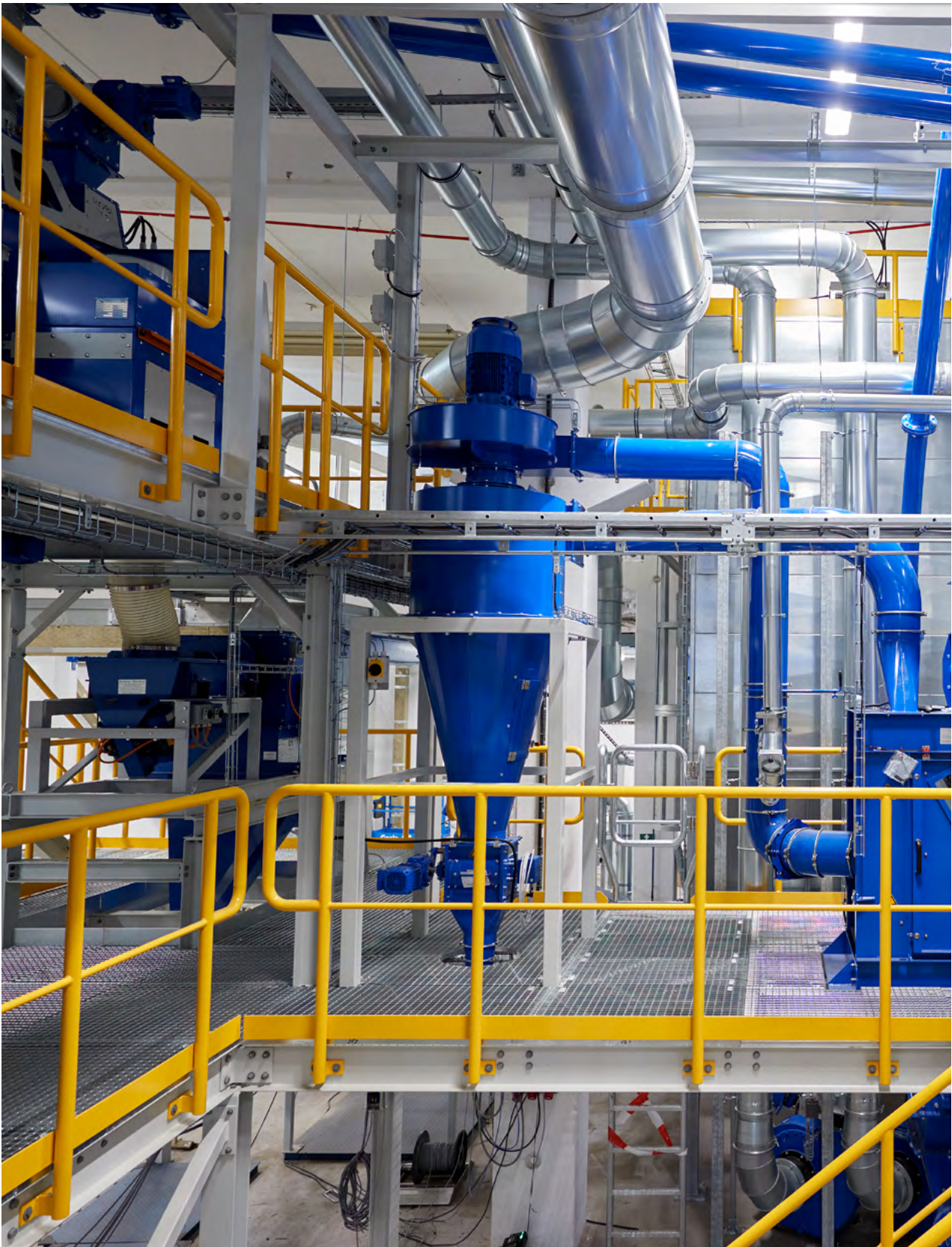
Stena Recycling öppnade en storskalig återvinningsanläggning för batterier år 2023. Foto: Stena Recycling
